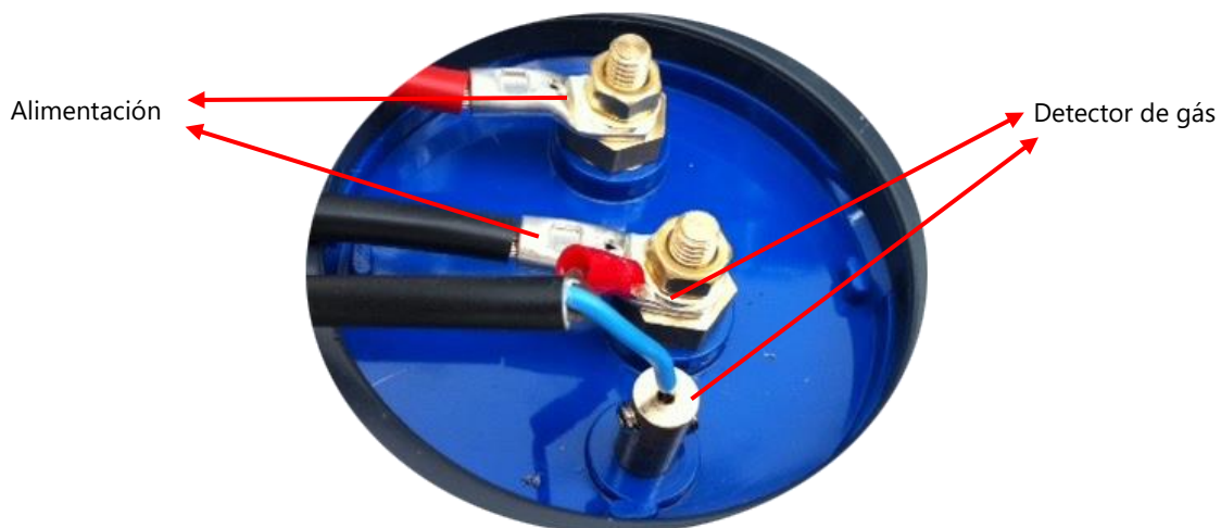
Figura 5 – Terminales de Conexión en la Celda
